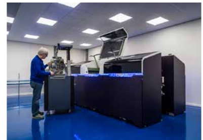
Foto: Asperitas 'ecoracks' met Immersed Computing® technologie
