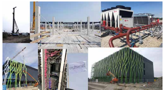
Afbeelding en foto's: Bytesnet datacenter D'root in Groningen
